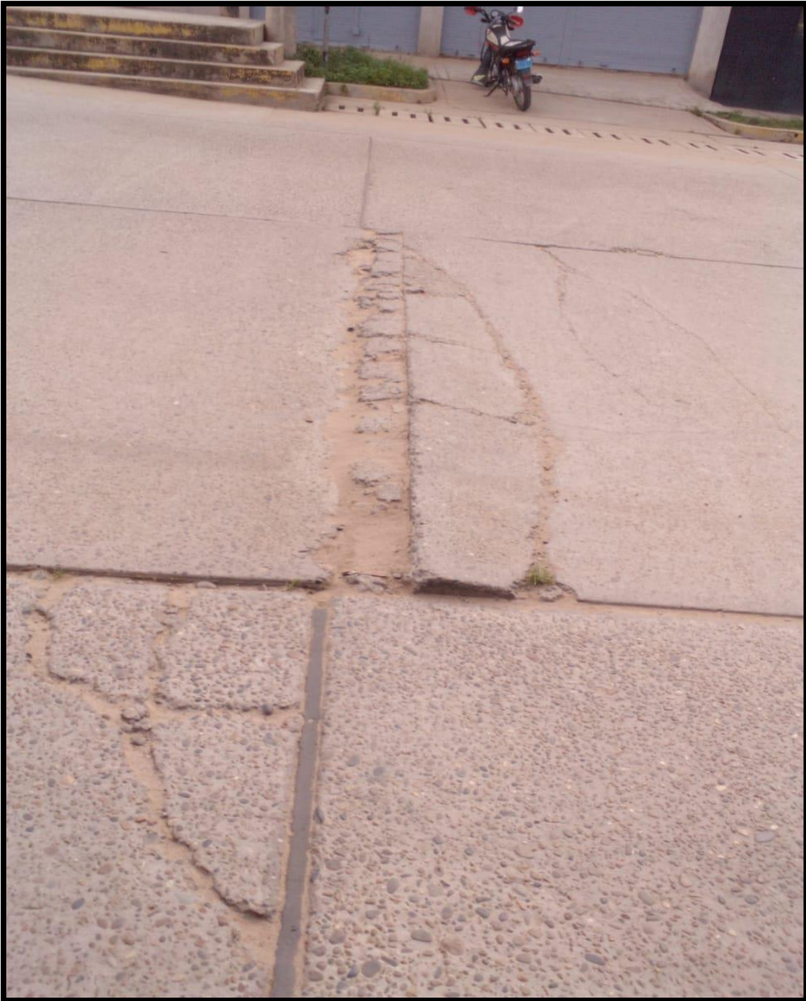
Figura N ° 16. paños dilatados que ocasionan que las juntas no tengan espacio y el pavimento se levante
