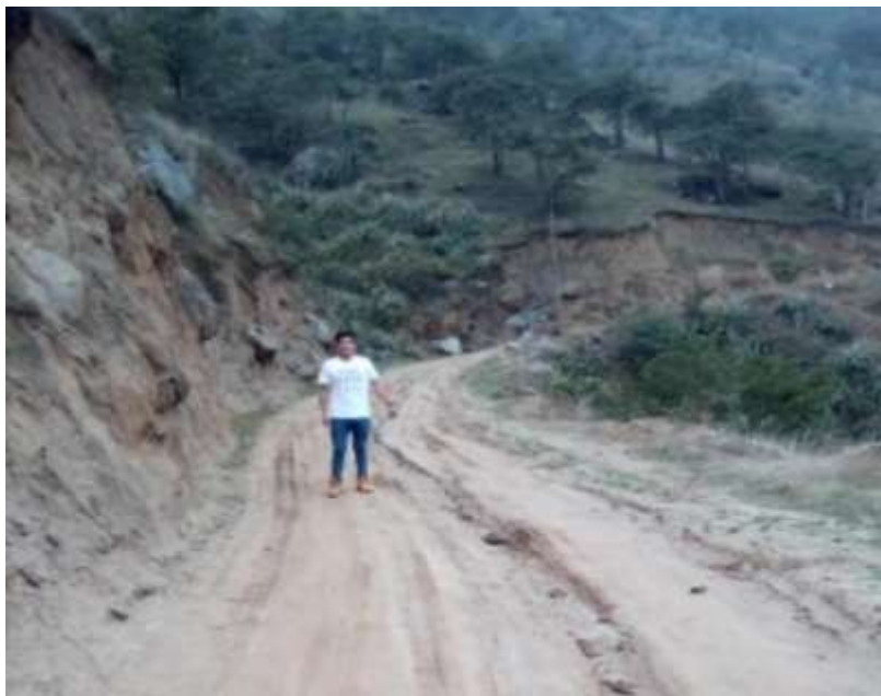
Foto 5. Ahuellamiento de la vía.
