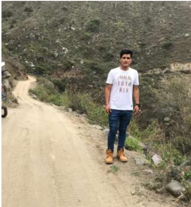
Foto 8. Incumplimiento de ancho mínimo de la vía.
