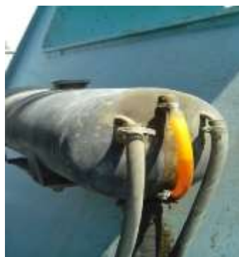
FIGURA 7: TANQUE DE EXPANSIÓN DE REFRIGERANTE
