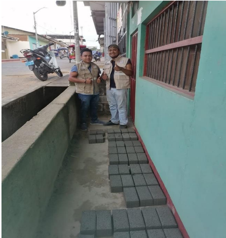
FOTO 09: Moldes del adoquín con los porcentajes determinados de ceniza de coronta de maíz amarillo.
