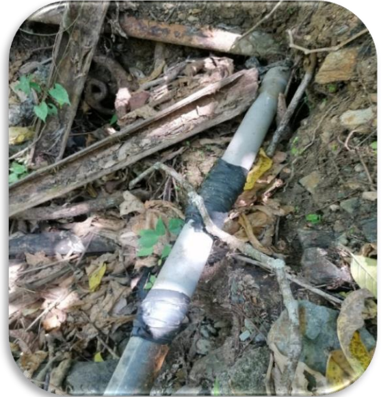
IMAGEN 2: Tubería de 2” en mal estado, parchadas con cámara de llanta por la filtración del agua, no teniendo un mantenimiento correcto.
