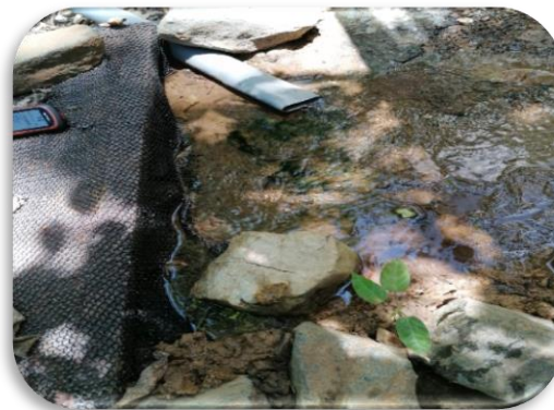
IMAGEN 10: Se observa que el agua de la fuente de captación esta expuesta a contaminación ya que sirve como criadero de zancudos.
