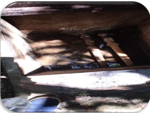
IMAGEN 3: Se observa que las tuberías y las válvulas estan en mal estado, parchadas con cámara de llanta.
