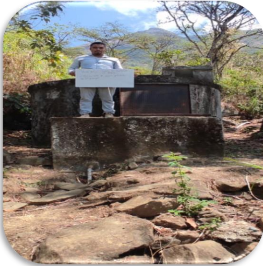
IMAGEN 5: Segunda fuente de captación, se observa que en la estructura de concreto se esta deteriorando debido a la filtracion de agua.
