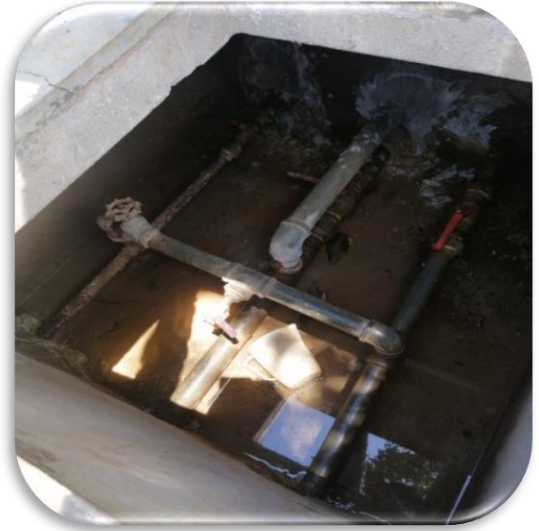
IMAGEN 6: Se observa que la tapa metálica esta oxidada y las paredes de concreto con manchas negras debido a la filtración del agua.
