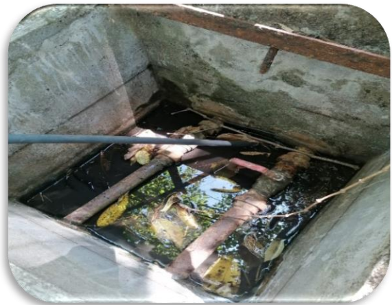
IMAGEN 4: Se observa que dentro de la captación las paredes de concreto no estan tarrageadas y con musgo producto de que no hay un mantenimiento correspondido.
