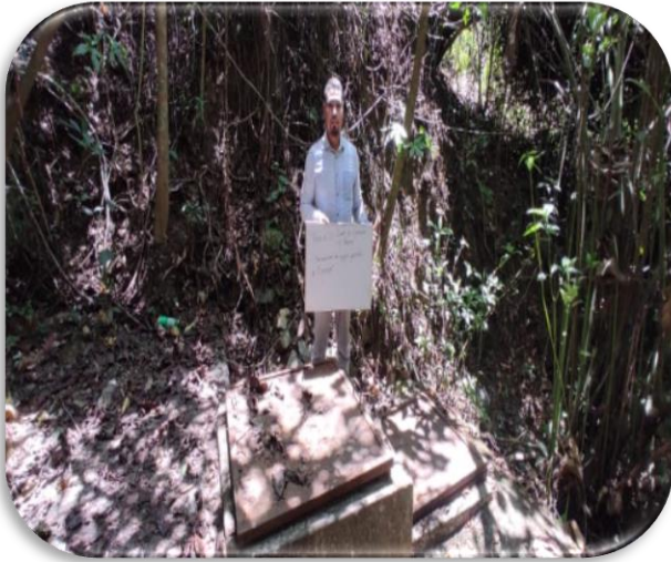
IMAGEN 1: Primera fuente de captación, se observa que en la estructura esta deteriorada cubierto de musgos y oxidado en la parte de la tapa metálica.
