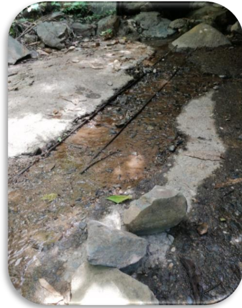
IMAGEN 9: El agua que corre por la fuente de captación esta expuesta pasando por varillas corrugadas de 1/2" oxidadas.
