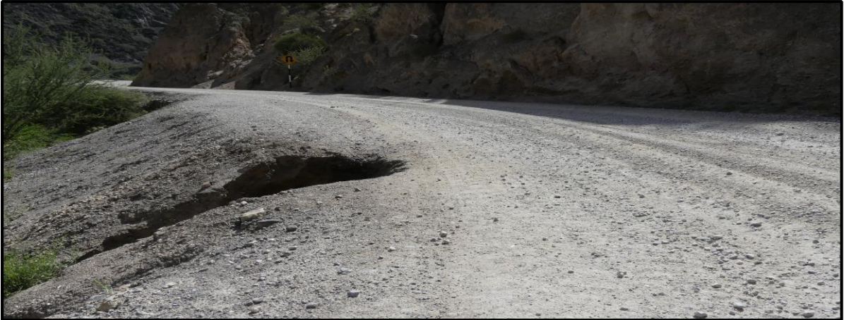
Fotografía 2. Estado de la situación de la carretera.
