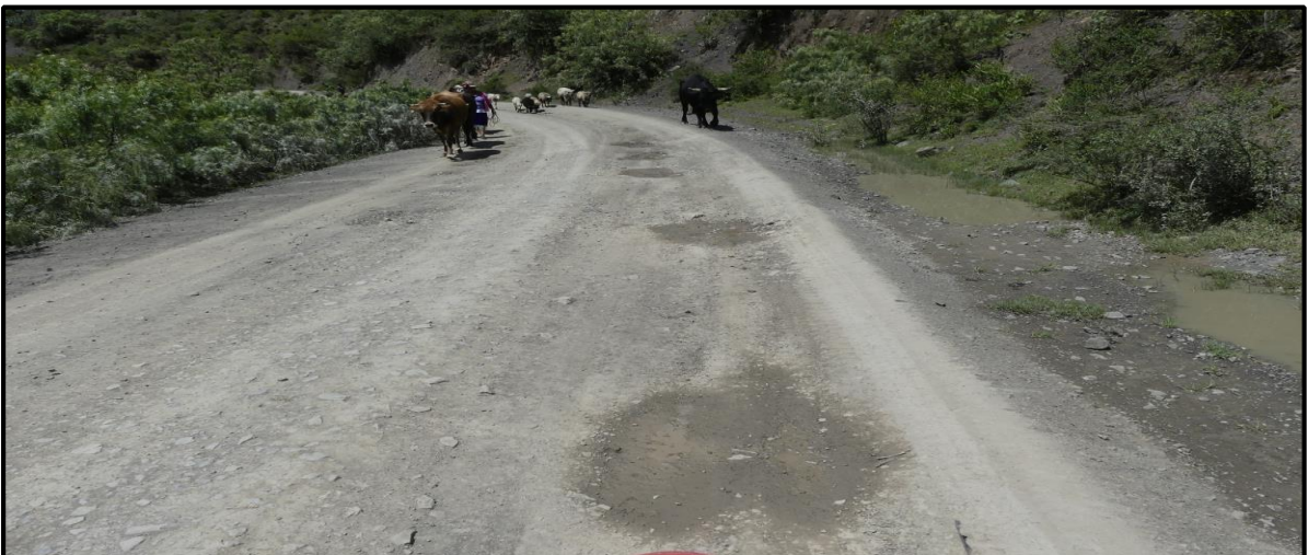
Fotografía 3. Deterioró de la carretera 12A.
