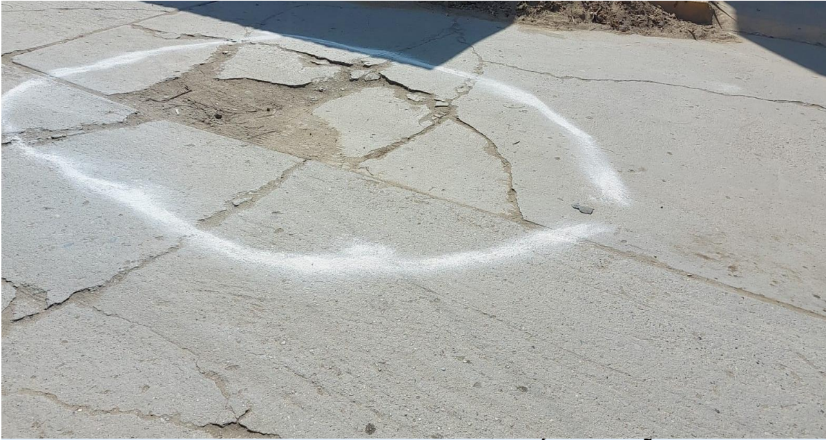
RECONOCIMIENTO DEL PAVIMENTO RÍGIDO DAÑADO
