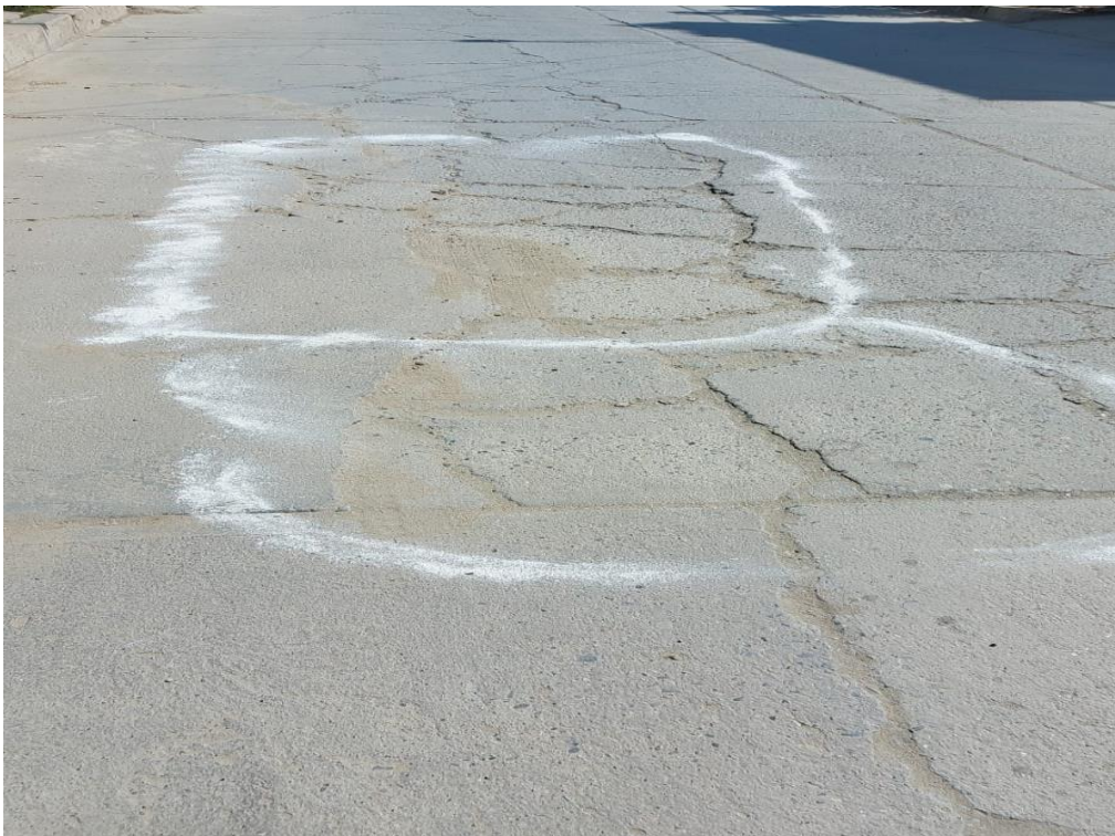
RECONOCIMIENTO DEL PAVIMENTO RÍGIDO DAÑADO
