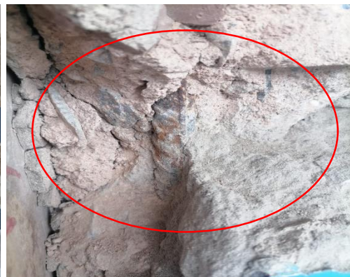
Figura 4.15. Corrosión de acero en columna
