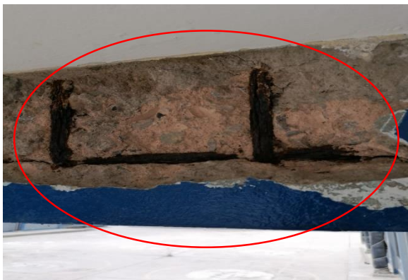
Figura 4.14. Corrosión de acero, longitudinal y transversal
