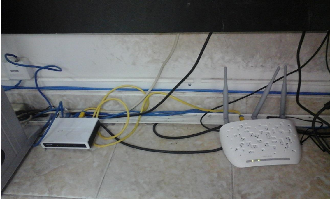
Ilustración 14:FIG. 4 CABLES DESORDENADOS
