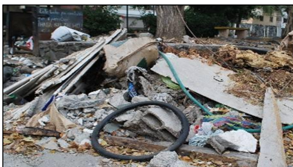
Figura 1. Residuos de construcción peligrosos Fuente: El Universo.
