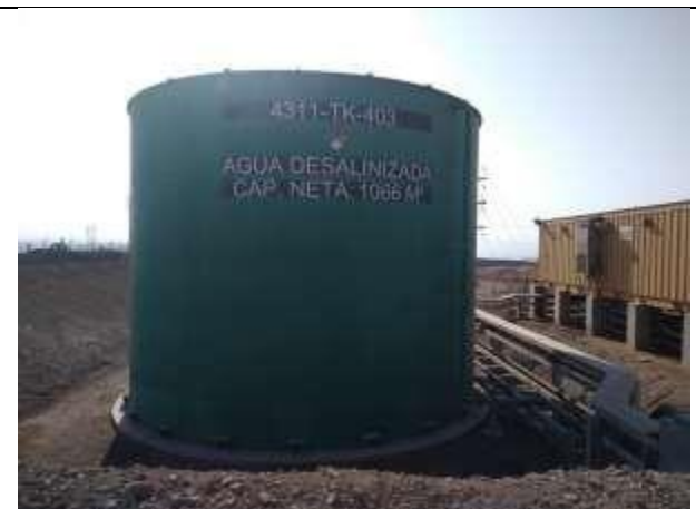
Planta desalinizada – primera tecnología ambiental aplicada
