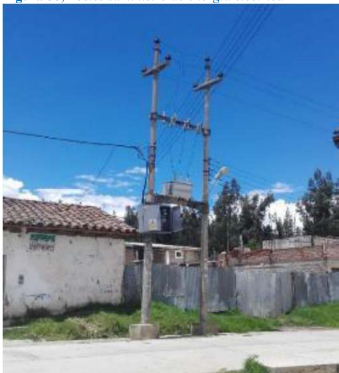
Figura 58, Postes suministro de energía eléctrica
