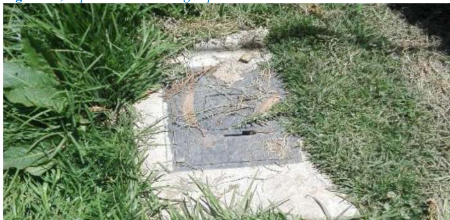
Figura 56, Tapa suministro de Agua potable
