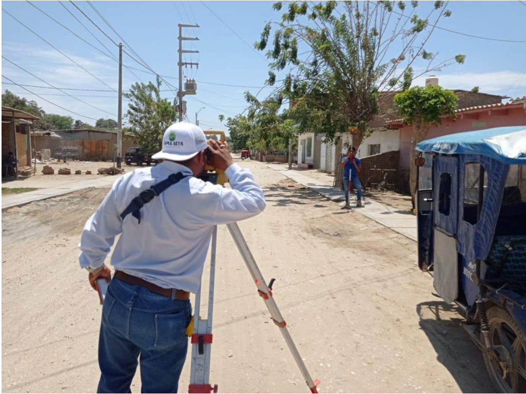
FOTO: TOMA DE PUNTOS CON ESTACION TOTAL EN EL JIRÓN MARIANO DIAZ
