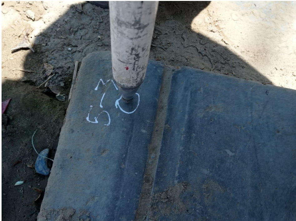
FOTO: UBICACIÓN DE PUNTOS PARA INSTALACIÓN DE ESTACIONES TOPOGRÁFICAS EN EL JIRÓN MARIANO DIAZ
