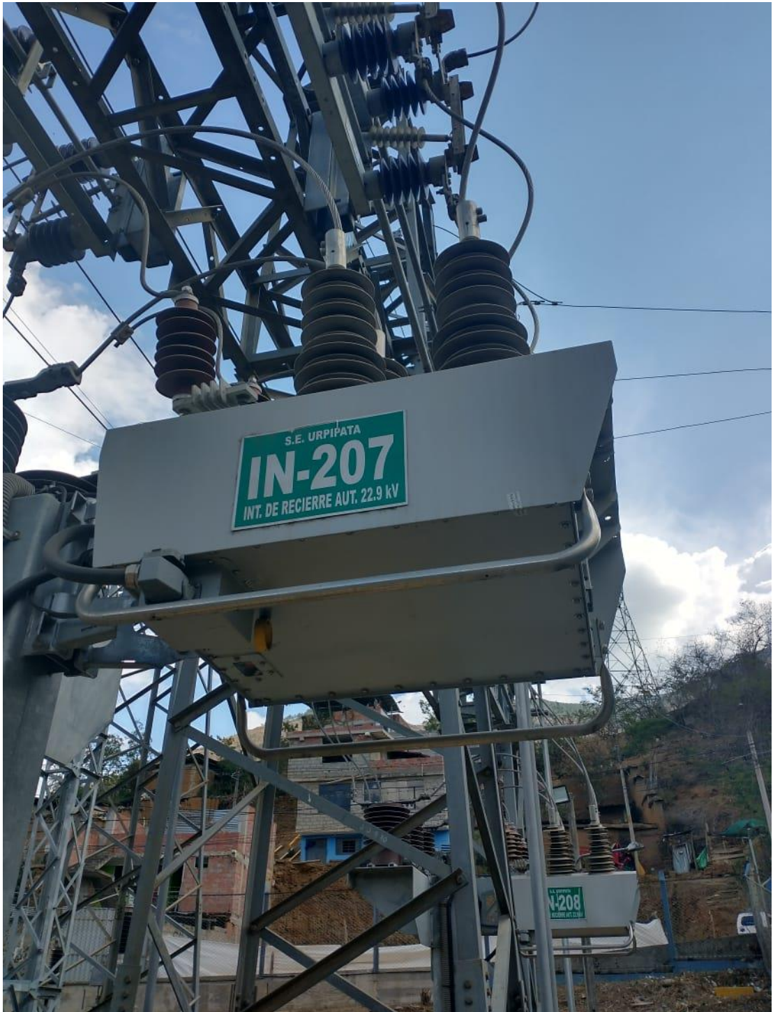
Reconectador (recloser) a la salida del alimentador UP04
