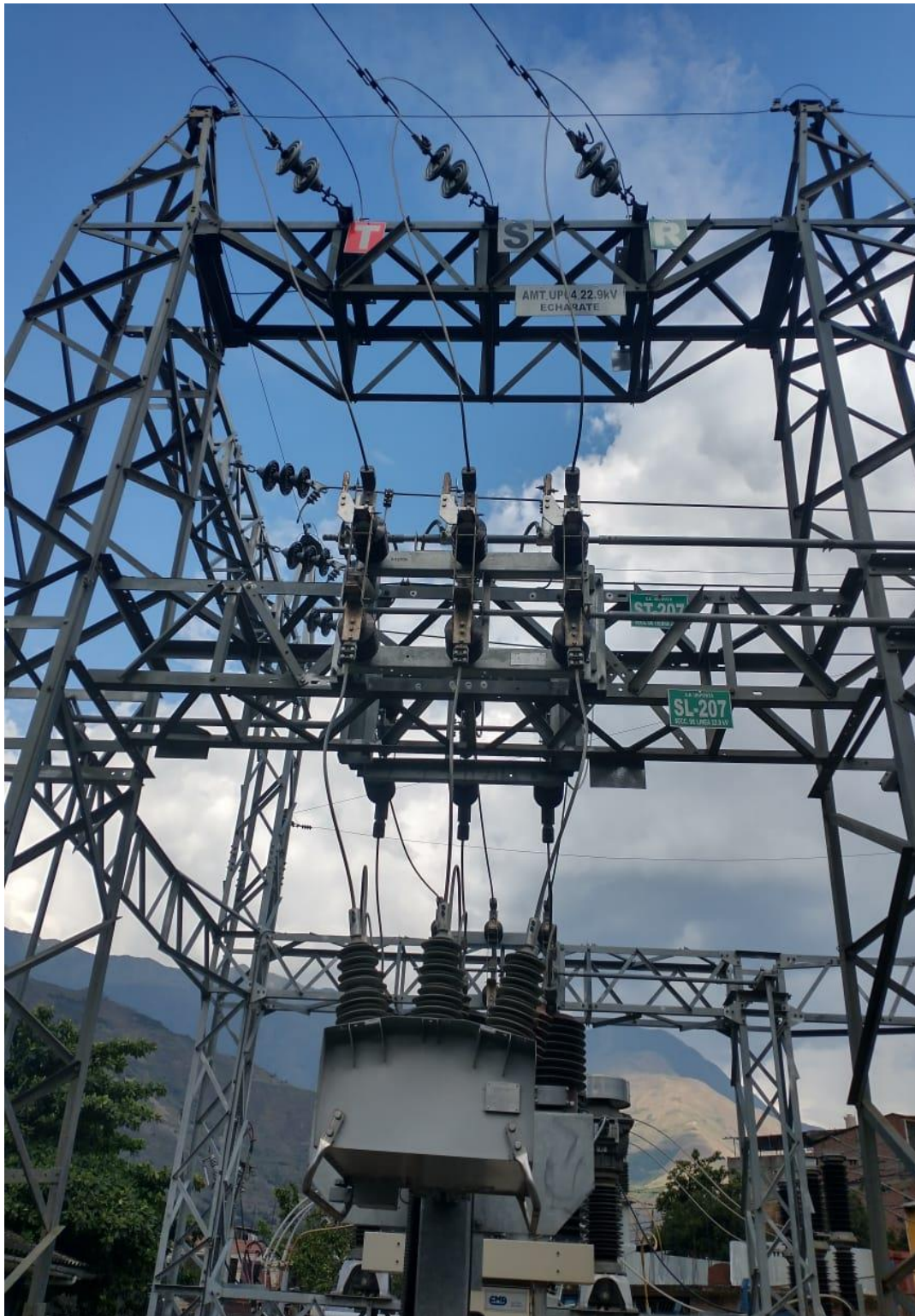
Salida del alimentador UP04 en SET Urpipata
