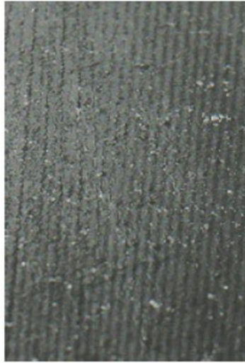
Figura 8. Exudación de Asfalto Fuente. Manual PCI, 2002.
