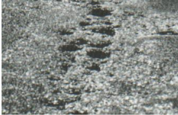
Figura 13. Meteorización / Desprendimiento de agregados
