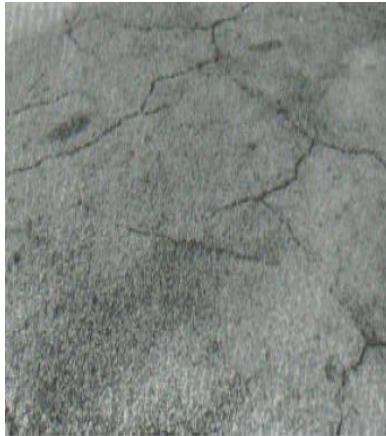
Figura 1. Agrietamiento en bloque Fuente. Manual PCI, 2002.
