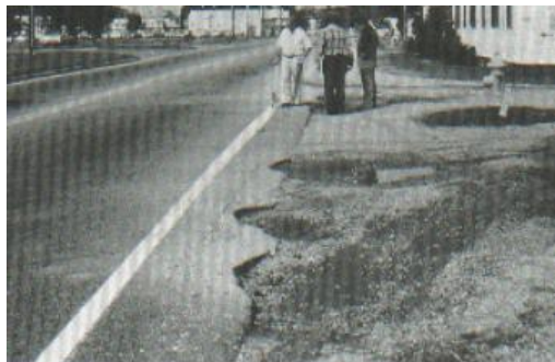
Figura 13. Grieta de borde
