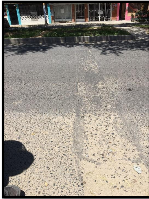
Figura 22: Parcheo de severidad alta.
