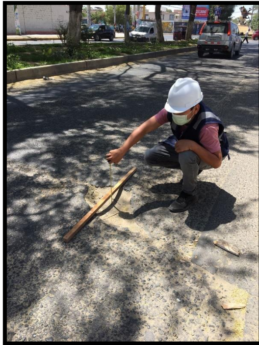
Figura 24: Huecos severidad nivel alto.
