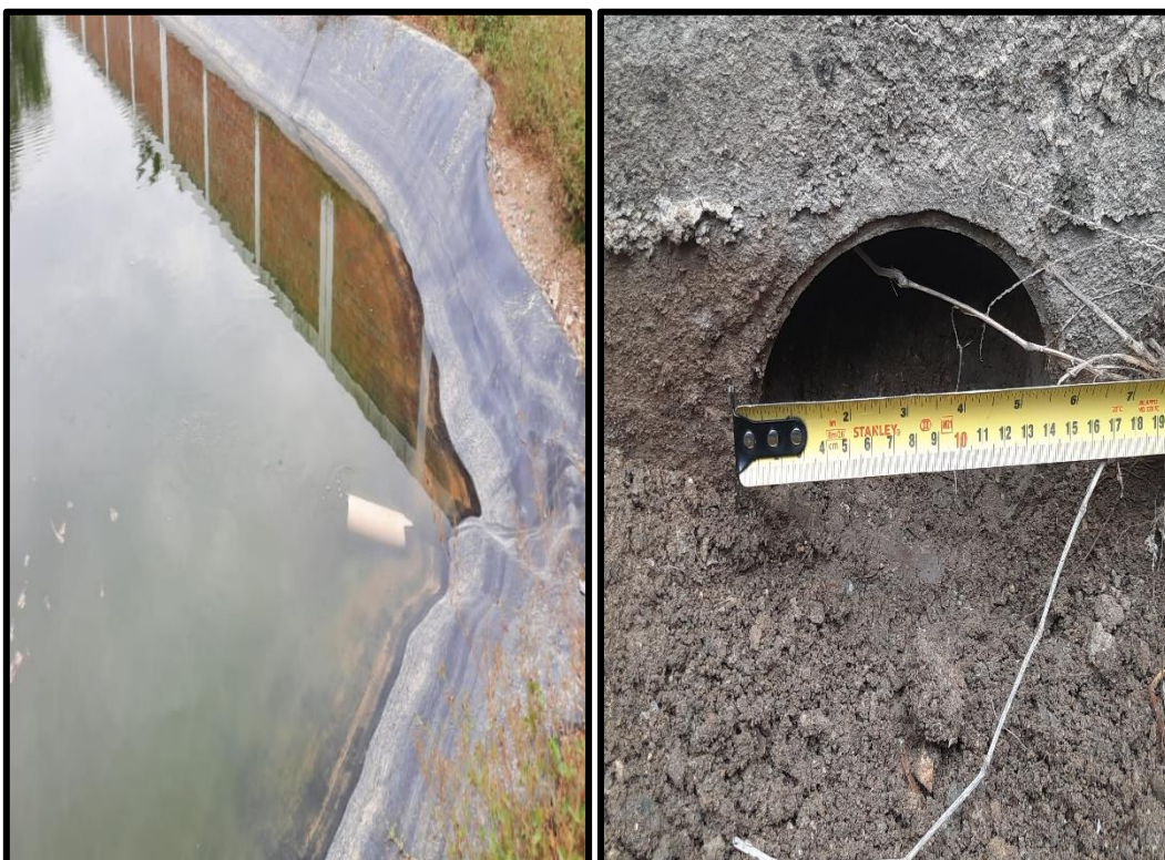
Fotografía N° 04: línea de conducción colmatada y tubería clandestina.
