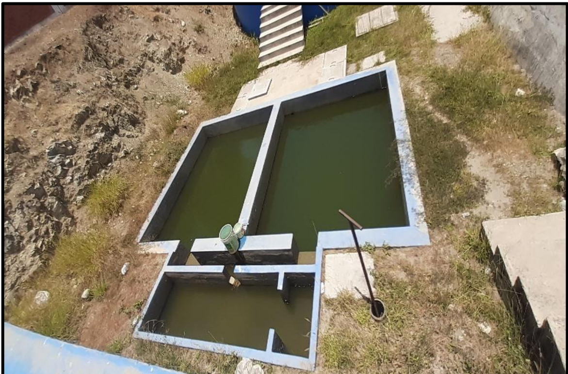
Fotografía N° 08: Planta de tratamiento de agua potable/ Filtro de arena.
