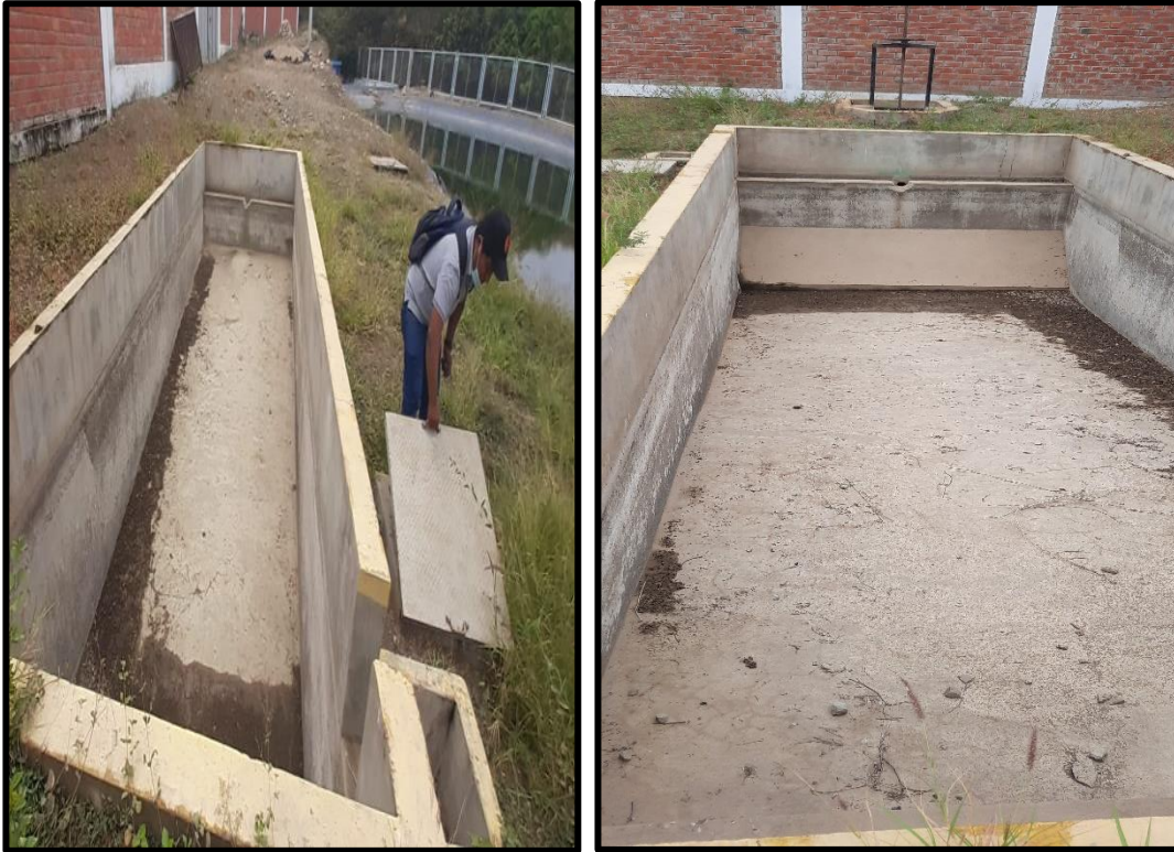
Fotografía N° 07: Sedimentador en Desuso.
