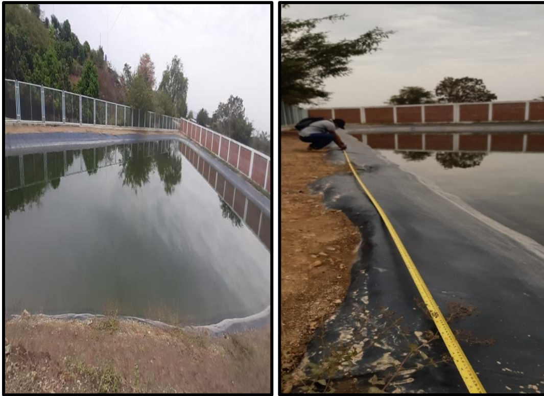
Fotografía N° 05: Reservorio de almacenamiento
