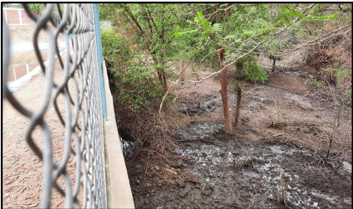
Fotografía N° 06: Filtraciones en Reservorio de almacenamiento
