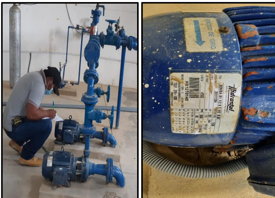
Fotografía N° 14: Detalles de Bombas.
