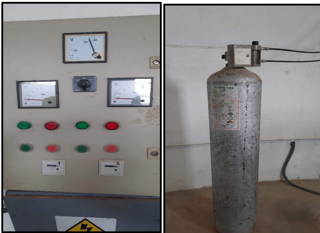
Fotografía N° 12: Tablero de control Eléctrico / Sistema de Clorado.
