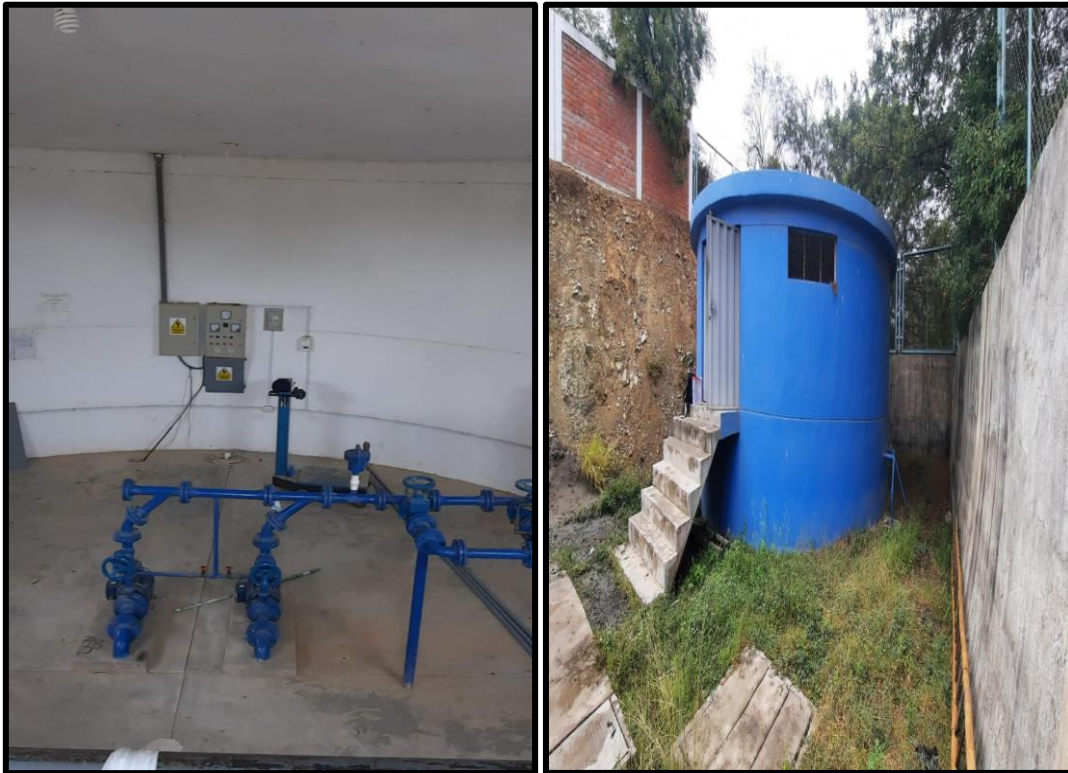
Fotografía N° 11: Estación de bombeo.
