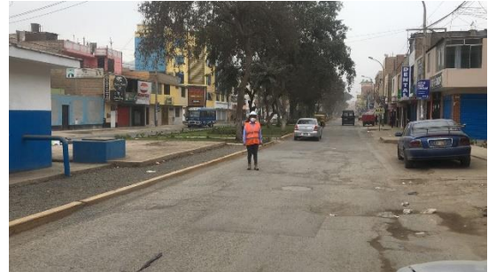
Foto 10. Grieta de Borde
