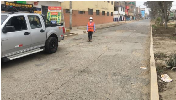
Foto 7. Grieta de Reflexión de junta
