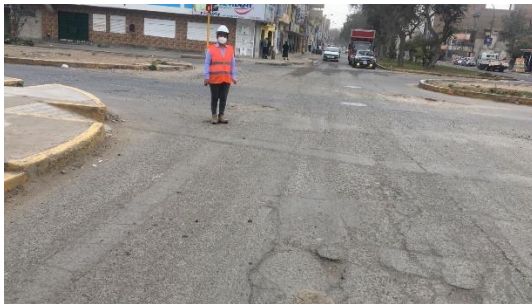
Foto 15. Agrietamiento en bloque
