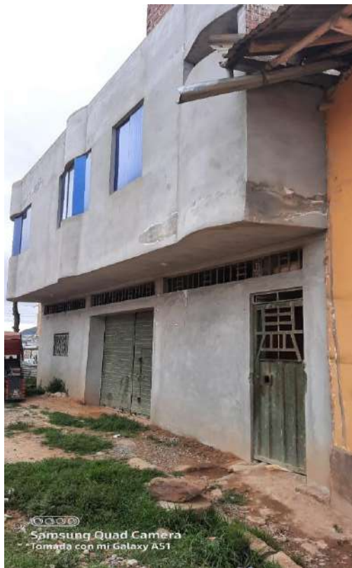
Figura 18. Humedad en la 2da planta.
