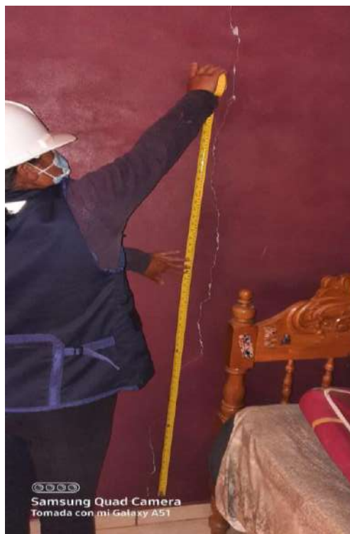
Figura 16. Fisura por asentamiento.
