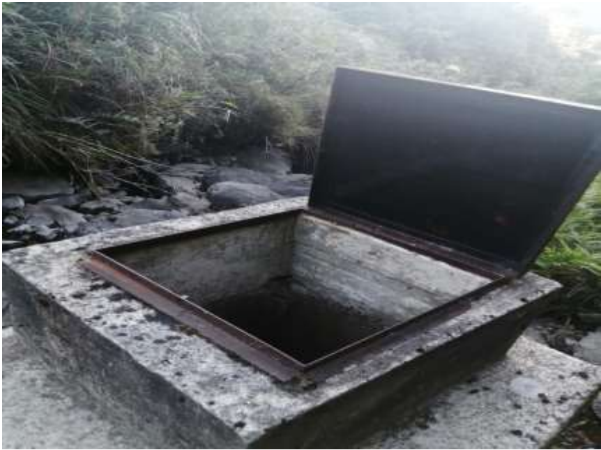
Figura 3. Captación de agua que abastece a la PTAP
