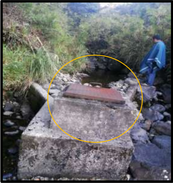
Figura 9. Problemas encontrados en la PTAP
