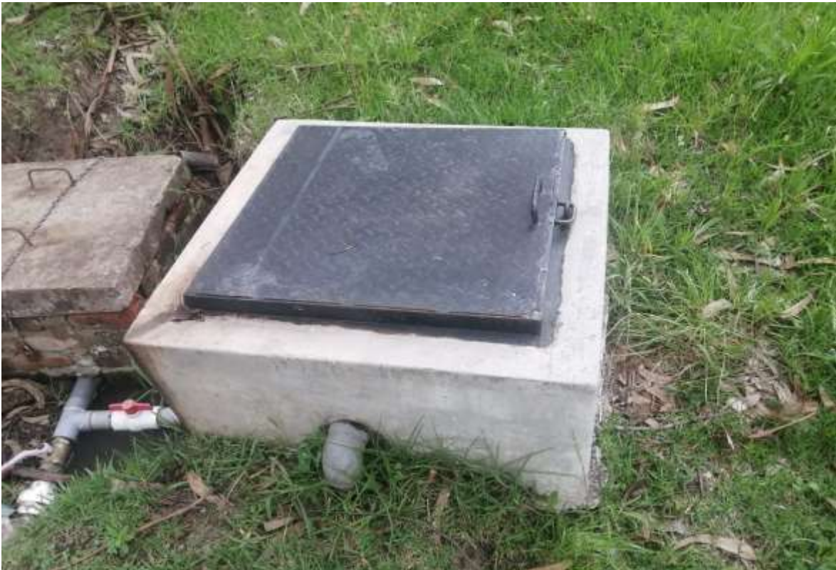
Figura 5. Cámara Rompe Presión
