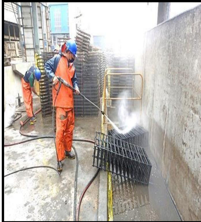
Lavado de relleno de propileno
