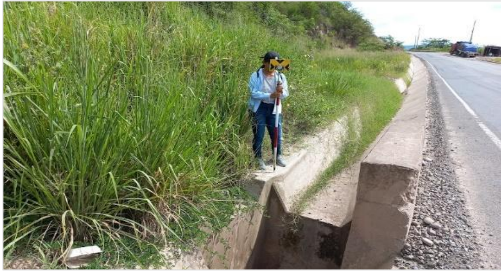
Figura 9: Ubicación del BMS en el alcantarillado existente
