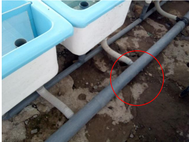
Figura 7: Tubería de agua de retorno (4”) al sistema de bombeo de agua Fuente: Empresa Inkas Trout E.I.R.L
