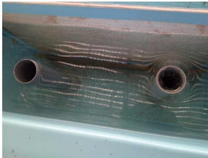
Figura 6: Tuberías de salida de agua para desagüe y sistema de bombeo Fuente: Empresa Inkas Trout E.I.R.L
