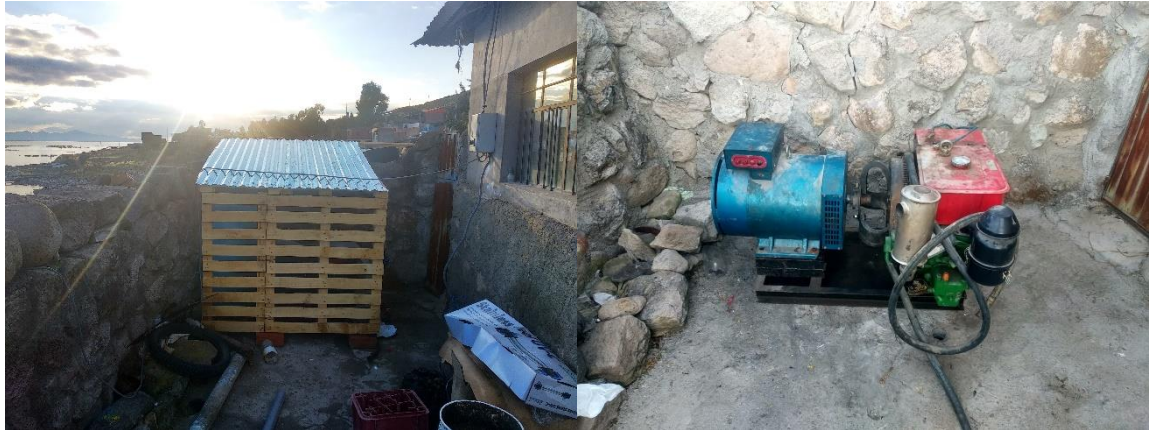
Figura 24: Generador de energía Fuente: Empresa Inkas Trout E.I.R.L
