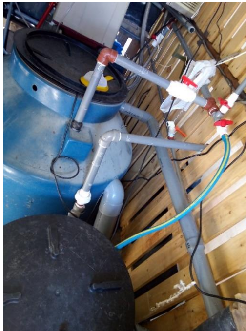
Figura 9: Instalaciones de agua y desagüe del sistema de bombeo de agua Fuente: Empresa Inkas Trout E.I.R.L
