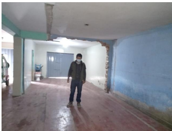
Figura 13. Inadecuada densidad de muros
