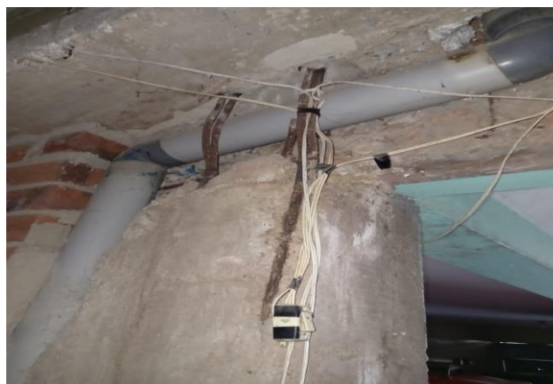
Figura 19. Muestra del acero expuesto al medio ambiente
