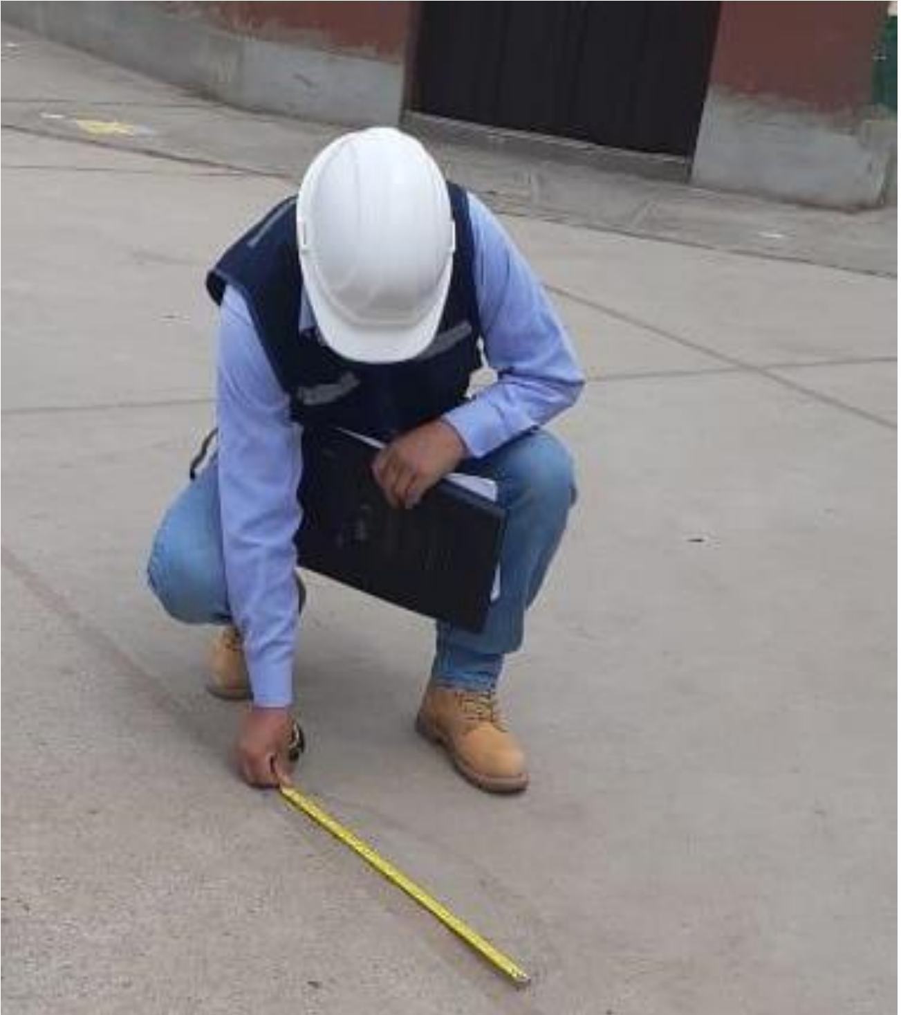
Toma 03: Vista de fallas de alta densidad.
