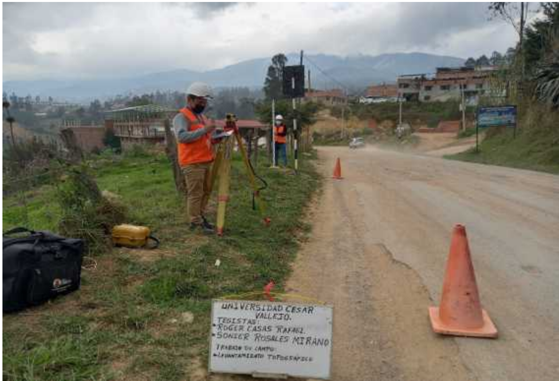
Fotografía 13. "Realizando nivelación de terreno con nivel de ingeniero en los puntos geodésicos"
