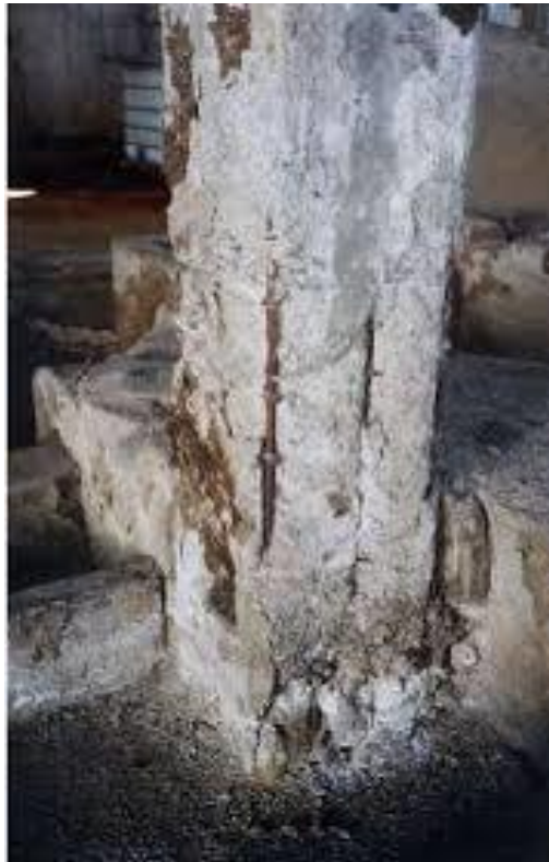
Fuente: Ataque de sales a estructuras
