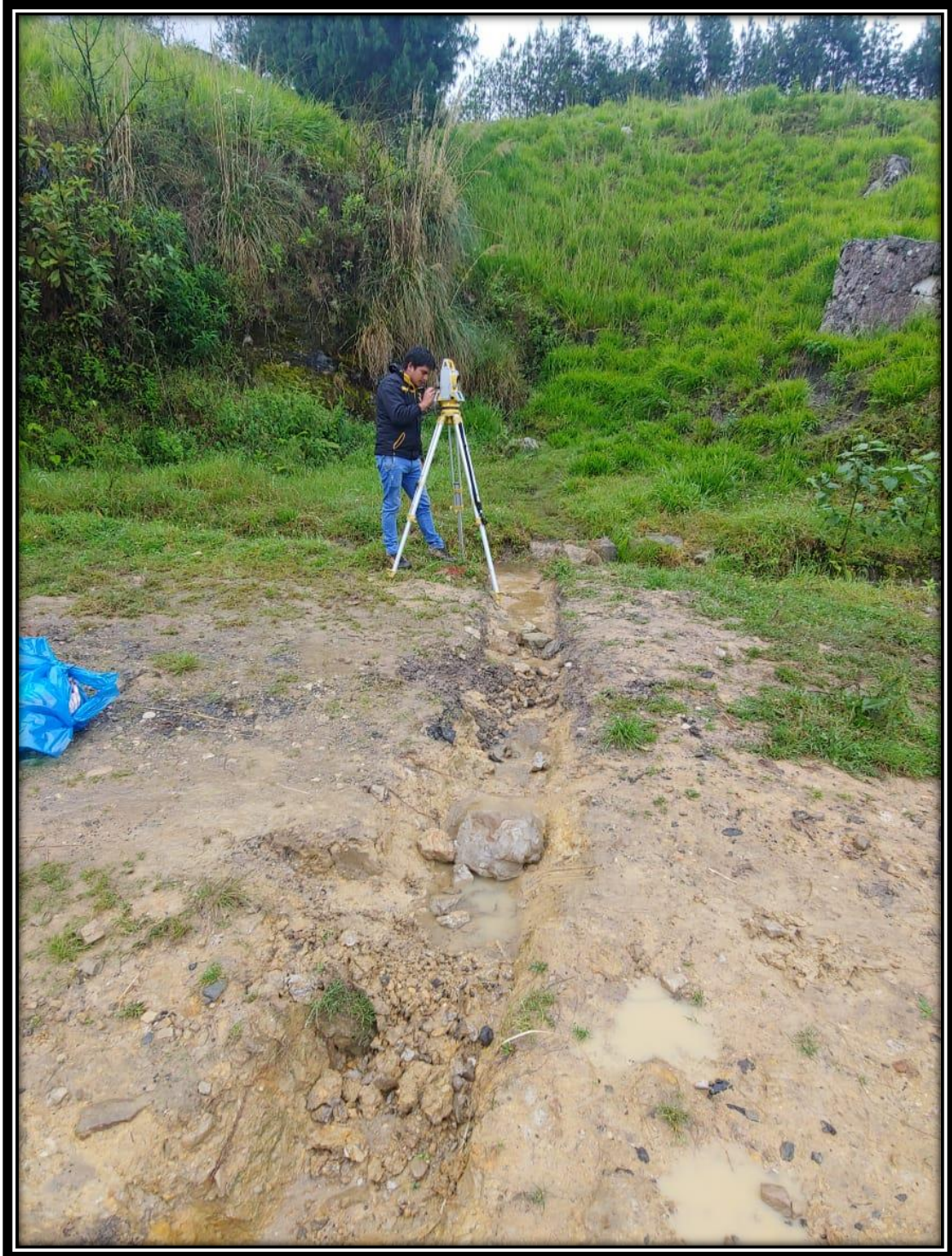
Foto 3. Carencias de estructuras de drenaje perpendicular.
