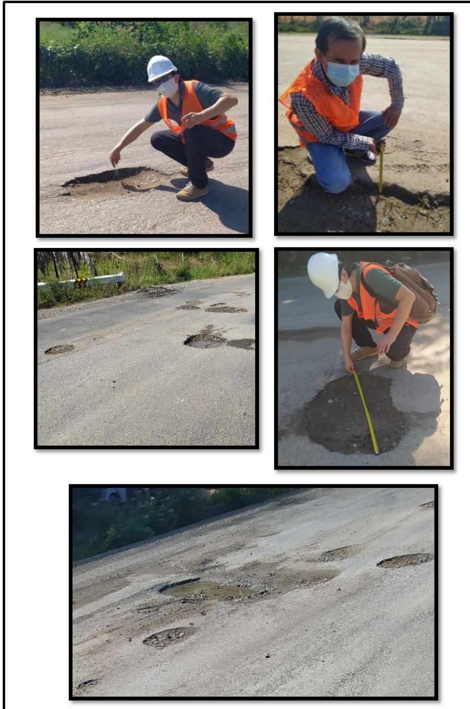
Figura 5 Huecos, falla con mayor frecuencia en la vía
