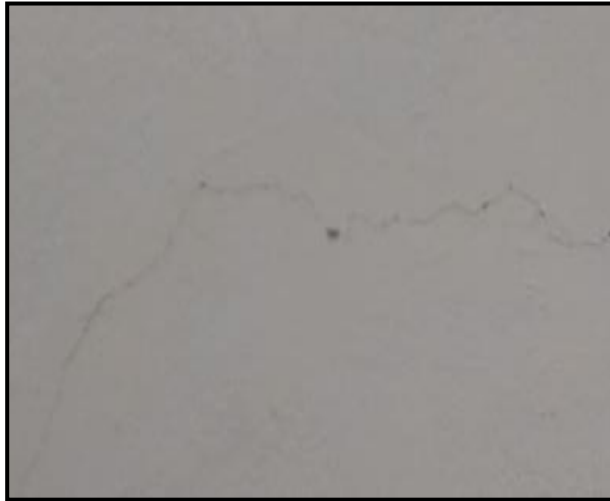
Figura 2: Foto panorámica de la problemática de Fisuras
