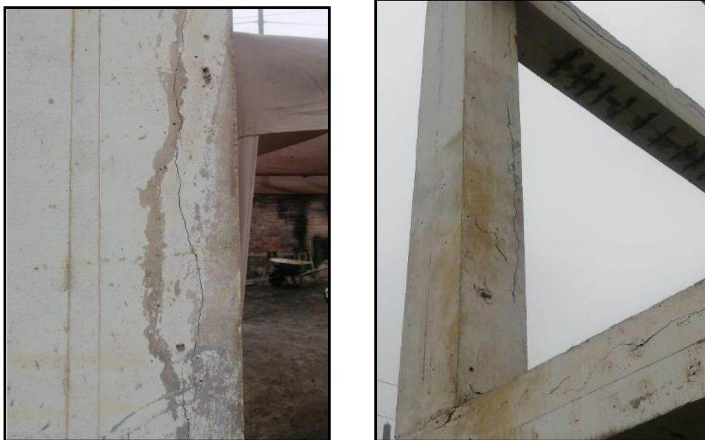
Figura 1: Foto panorámica de la problemática de Fisuras en las columnas y vigas
