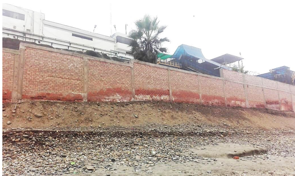
Figura N°1 Patología a causa de la humedad y sales en la cimentación, Malecón Santa Rosa.
