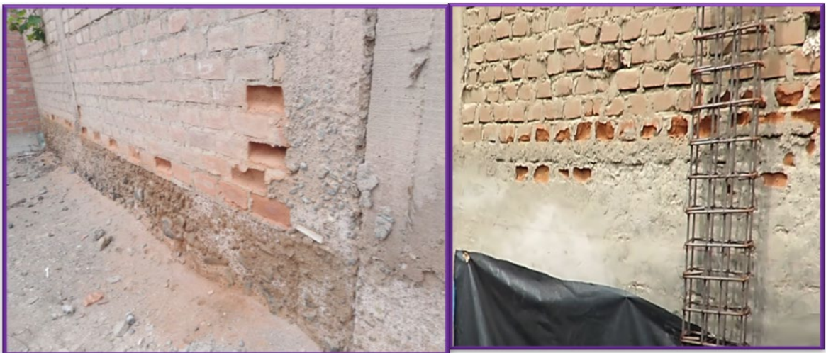
Figura N.º 19 Patologías en la cimentación presentes en la obra
