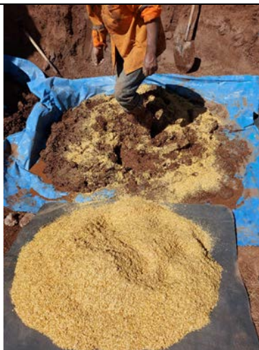
Paso N° 13: Colocado de cascarilla de café a la mezcla de barro
