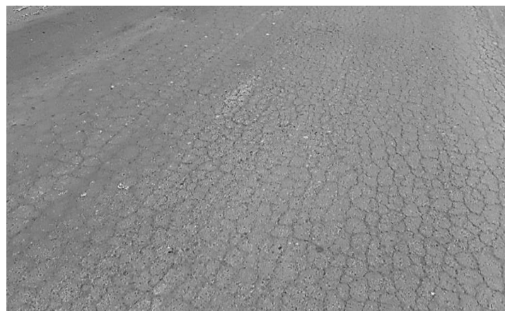
Figura 06. Grieta piel de cocodrilo
