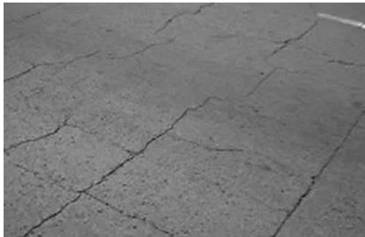
Figura 08. Agrietamiento en bloque
