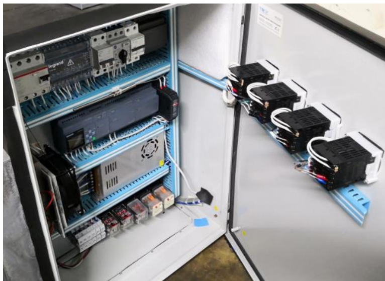
Figura 58. Aparatura eléctrica instalada en el tablero, vista general.
