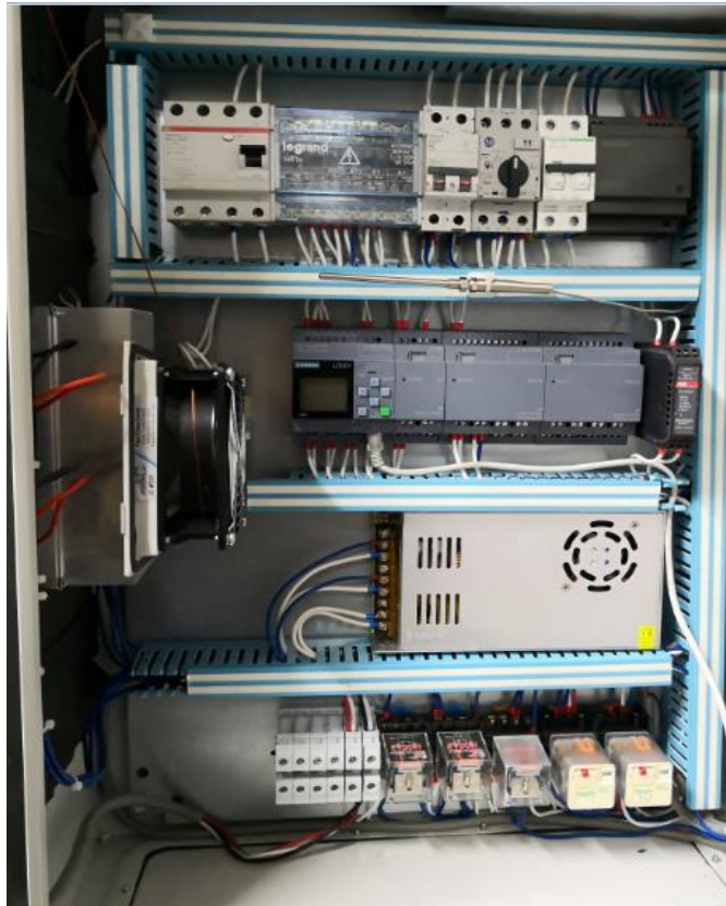
Figura 57. Aparatura eléctrica instalada en placa de montaje.
