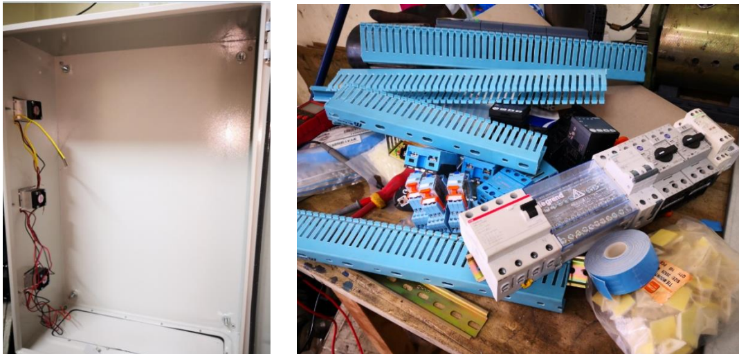
Figura 75. Tablero y Aparallaje utilizado en el ensamble del cuadro eléctrico.
