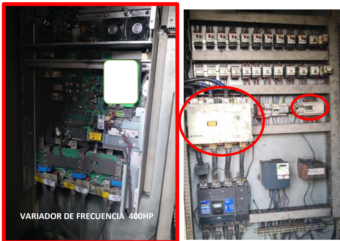
Figura 110. Elementos que fueron intervenidos durante el tercer año de producción
