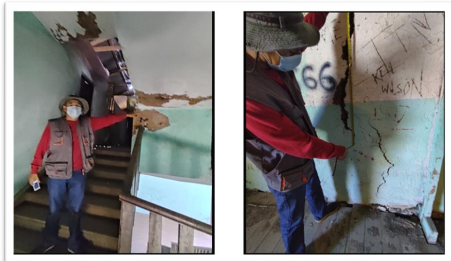
Figura 12. Fisuras y grietas en el recubrimiento de los muros.
