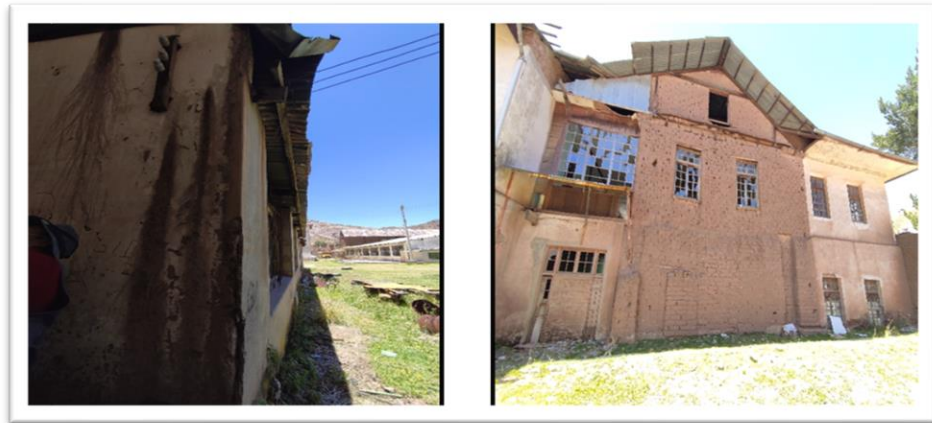
Figura 18. Fallas por la humedad en la Institución “José Antonio Encinas” Fuente: Producción propia de los tesistas.
