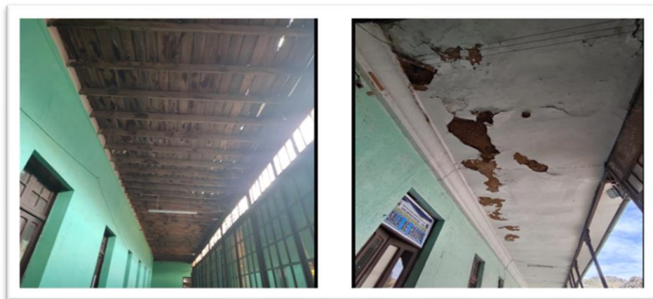
Figura 15. Pasadizo se visualiza el desprendimiento del cielo raso Fuente: Producción propia de los tesistas.
