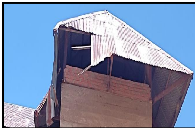
Figura 28. Alero de la cubierta deteriorado. Fuente: Producción propia de los tesisistas.
