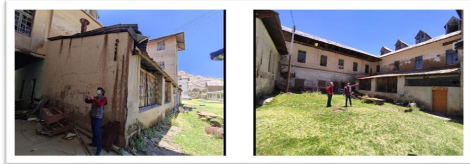
Figura 16. Visualización de la humedad en los muros y Fallas por la humedad en los muros
