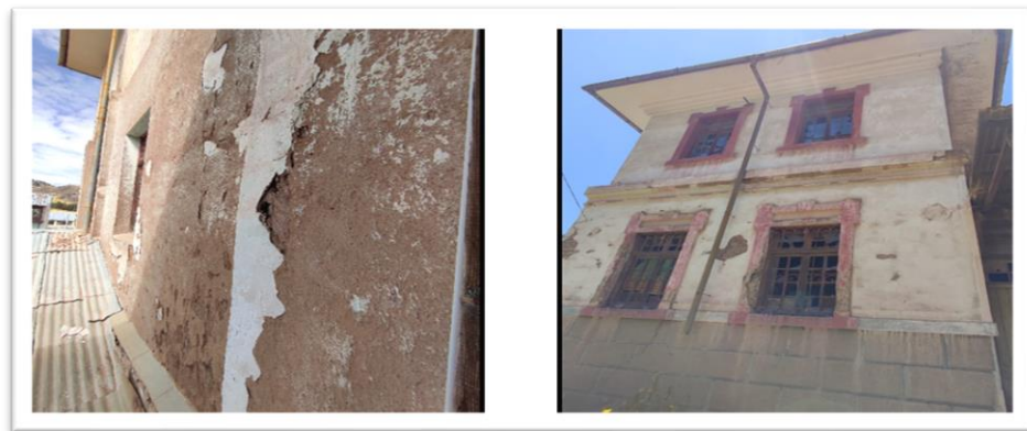
Figura 17. Desprendimiento del recubrimiento de la pared en la institución.
