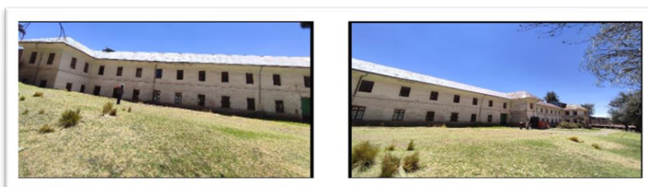
Figura 21- Daños perceptibles – Lado Este, según vistas de campo.
