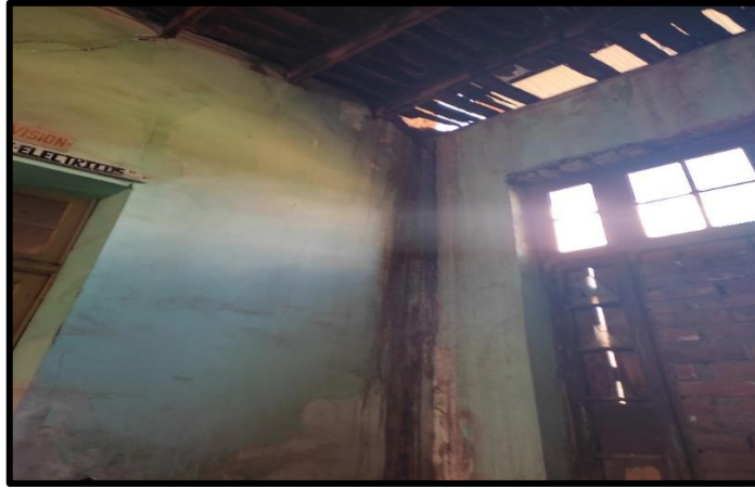
Figura 29. Presencia de agua impregnada en la zona inferior de los muros. Fuente: Producción propia de los tesistas.
