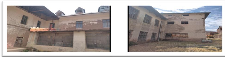
Figura 26. Daños visibles lado sur de la institución, según trabajos de campo.
