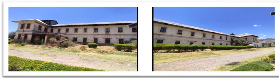
Figura 23. Daños visibles lado oeste de la institución, según trabajos de campo Fuente: Producción propia de los tesistas.
