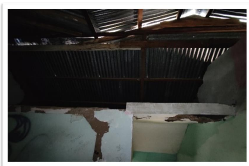
Figura 31. Desprendimiento del enlucido de yeso a causa de la filtración de agua.
