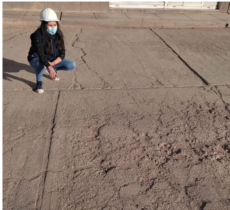
VISTA 02: Fallas en pavimento rígido
