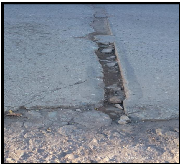
Nota: Gravedad 1- Solamente una esquina quebrada.
