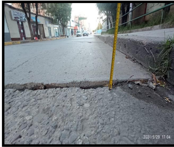
Figura 29: Gravedad 2-Desnivel de losas
