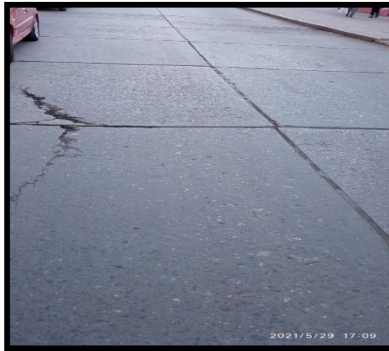
Figura 35: Gravedad 3- Fisuras longitudinales.
