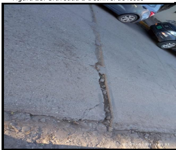
Figura 28: Gravedad 1-Desnivel de losas
