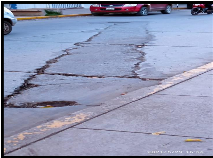
Nota: Gravedad 2-Puntuales (entre el 10% y 30% de la superficie de la losa afectada)
