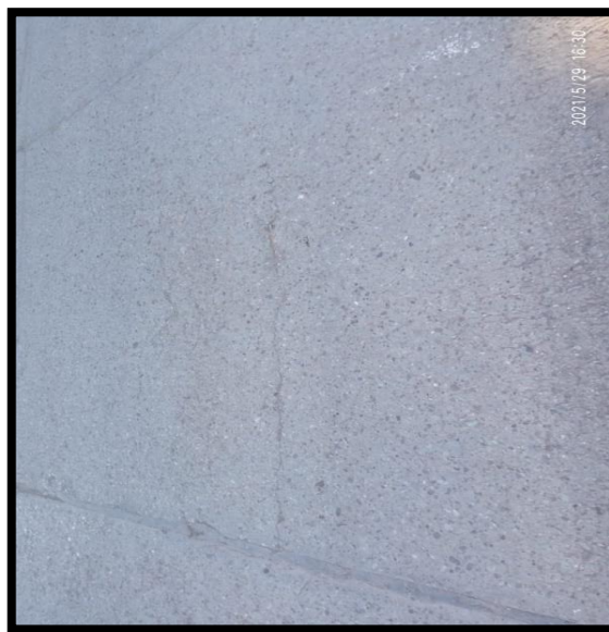
Figura 31: Gravedad 1- Fisuras longitudinales
