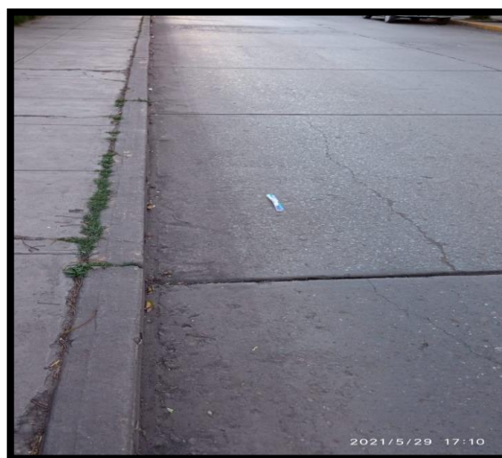
Figura 33: Gravedad 2- Fisuras longitudinales.
