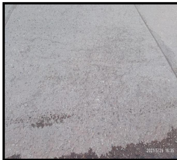
Nota: Gravedad 1- Fisuras transversales.
