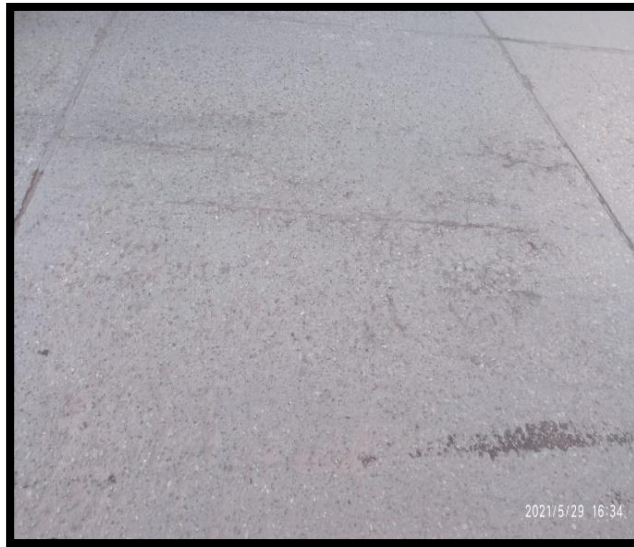
Figura 41: Gravedad 2-Fisuras transversales.
