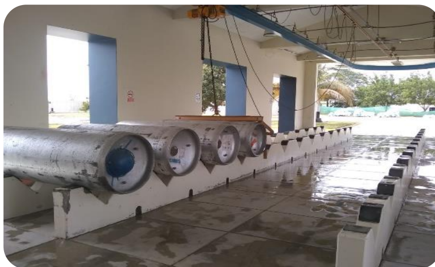
Figura 02: Limpieza en sala de cloración
