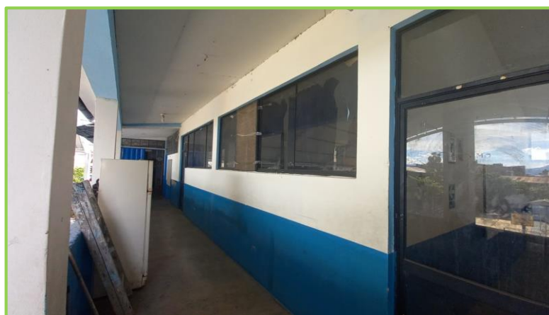
Figura N°43: Presencia de Columna corta en el tercer nivel
