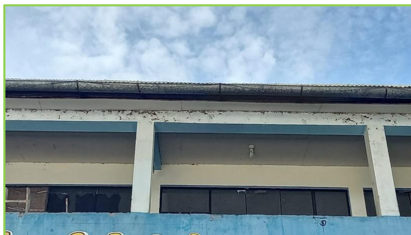
Figura N°46: Deterioro de viga de borde
