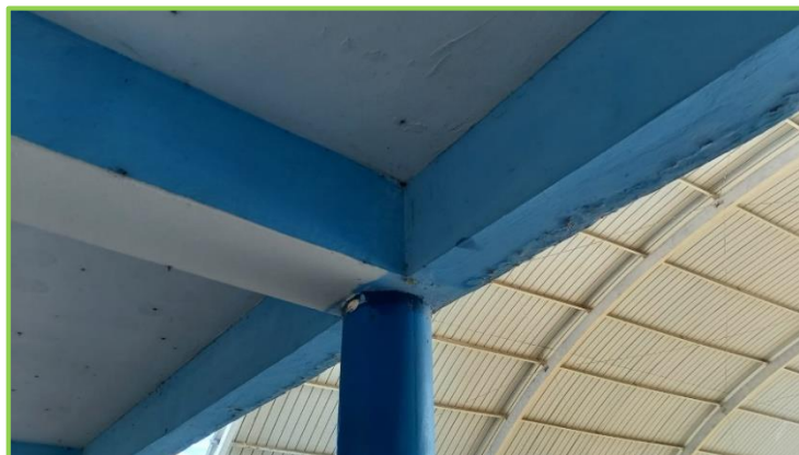
Figura N°48: Desprendimiento de concreto en vigas secundarias.
