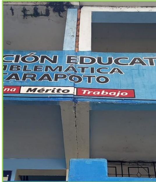
Figura N°47: Junta cero en separación de edificio.
