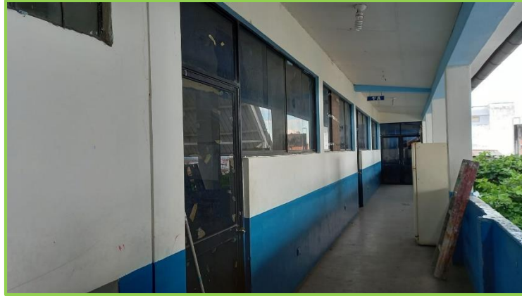
Figura N°34: Vista de deficiencia de anclaje de muro con columna
