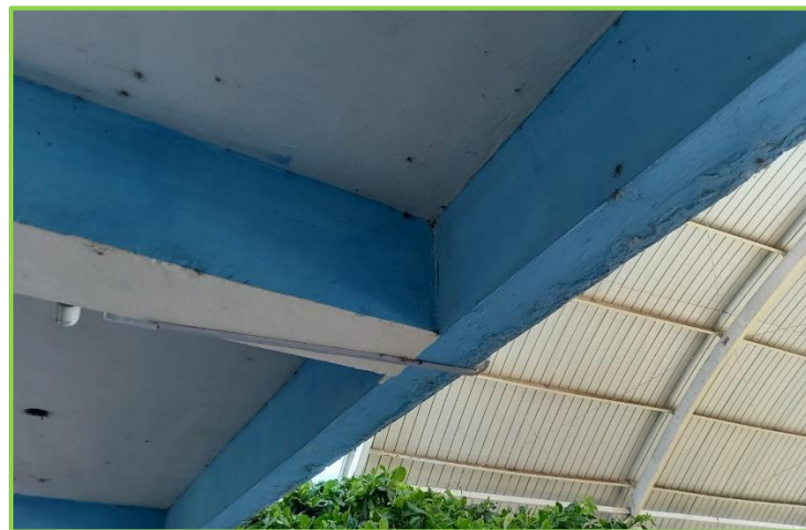
Figura N°33: Vista de desprendimiento de concreto en borde de viga.
