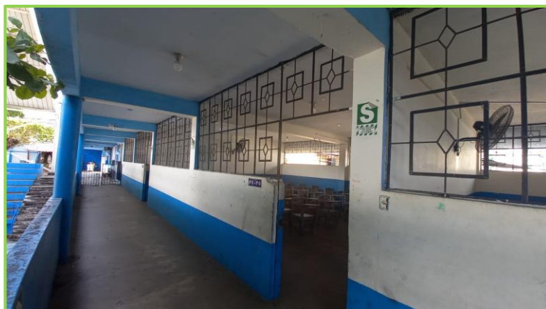
Figura N°42: Presencia de Columna corta en el segundo nivel
