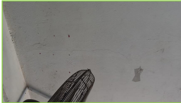
Figura N°45: Desprendimiento de concreto en viguetas.
