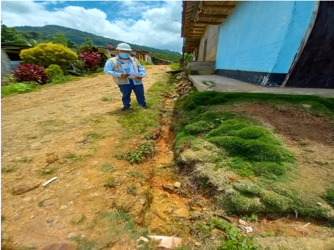
Anexo 10-C: Reconocimiento de campo-Drenaje pluvial improvisado por la población
