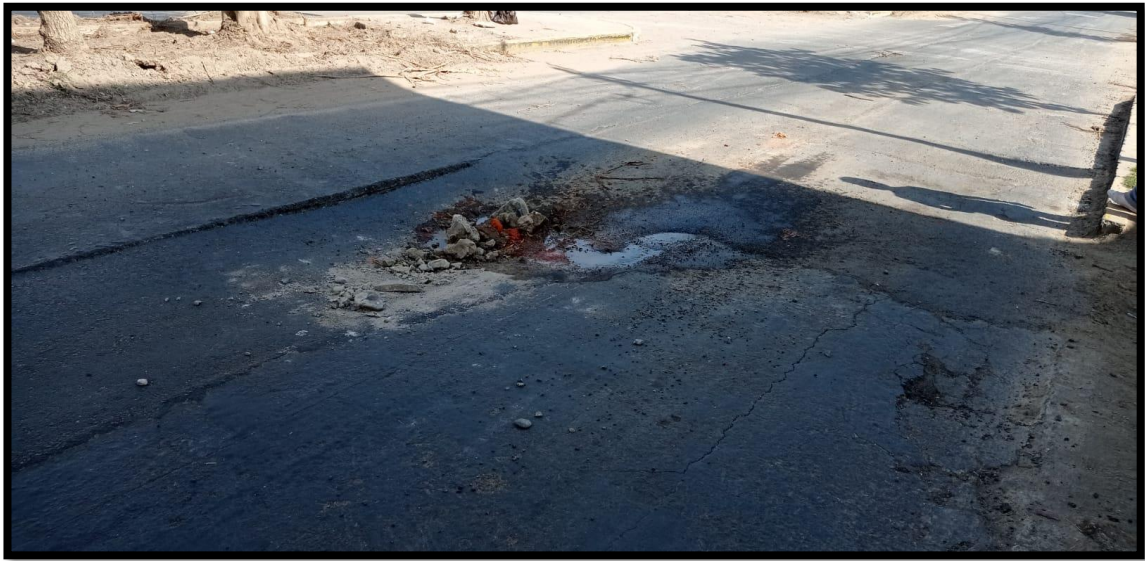
Figura 9. Abultamientos y hundimientos
