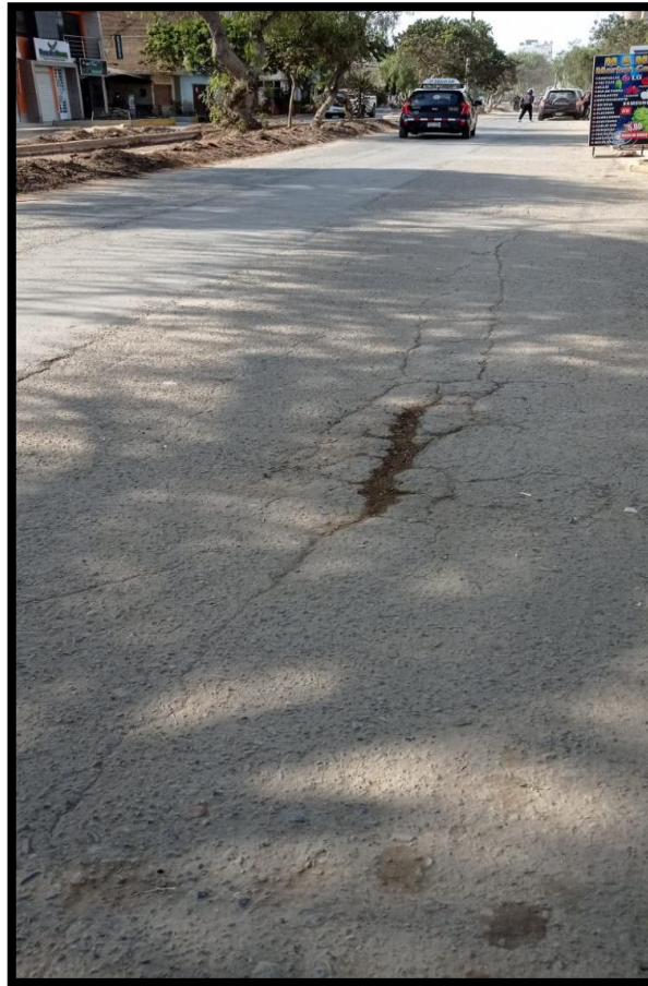
Figura 11. Grietas longitudinales y transversales
