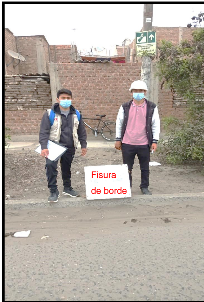
Figura 10. Fisura de borde
