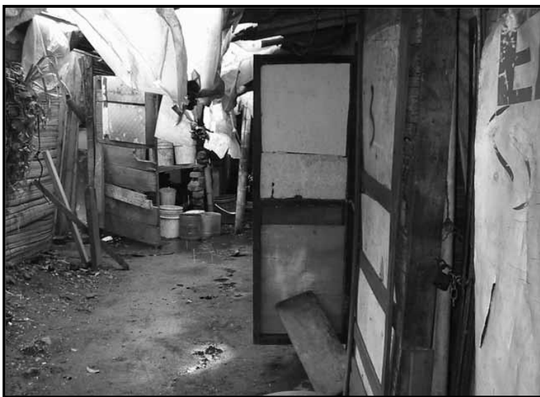
Figura 26. Vivienda en estado de Precariedad.
