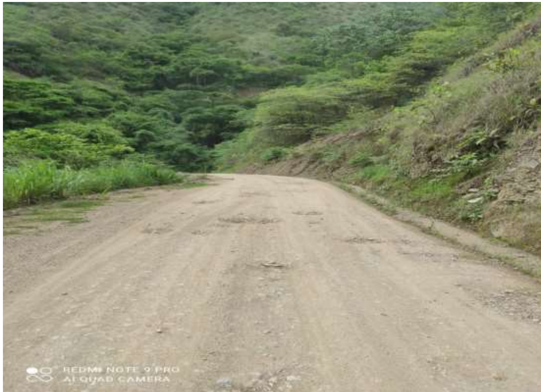
Figura 4. Deformaciones en la carretera de Pacaybamba - Amaybamba
