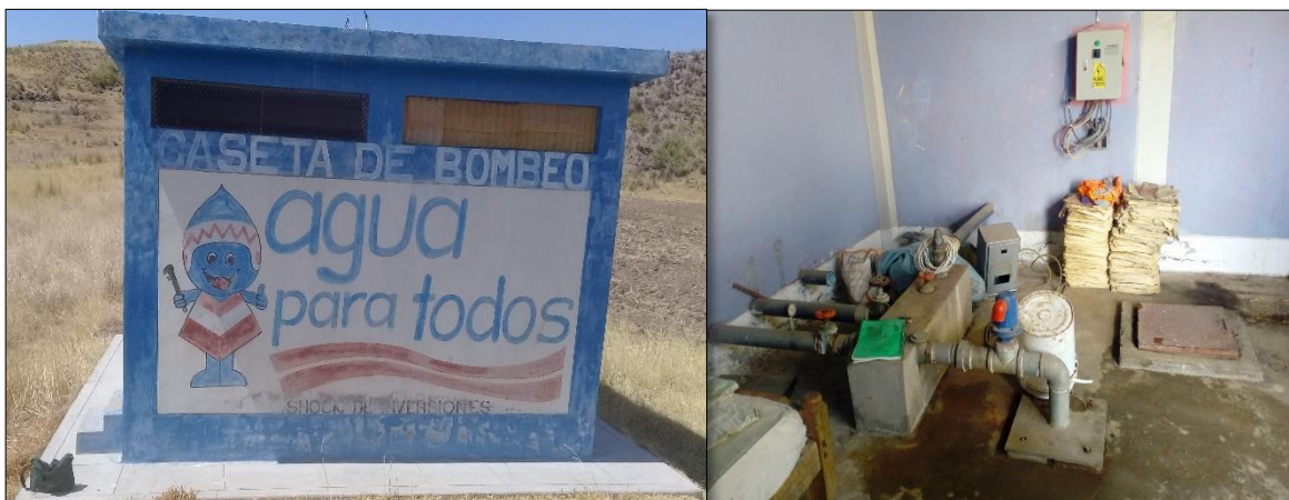
Figura 1. Estación de bombeo
