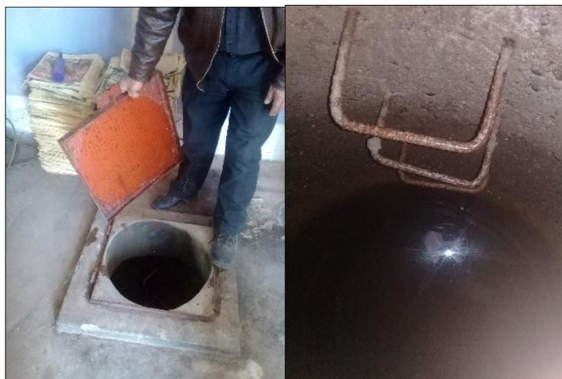
Figura 11. Áreas afectadas del pozo de succión.
