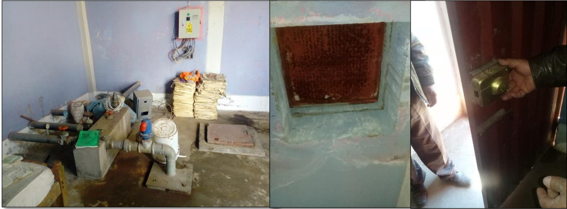
Figura 10. Áreas afectadas de la caseta de bombeo
