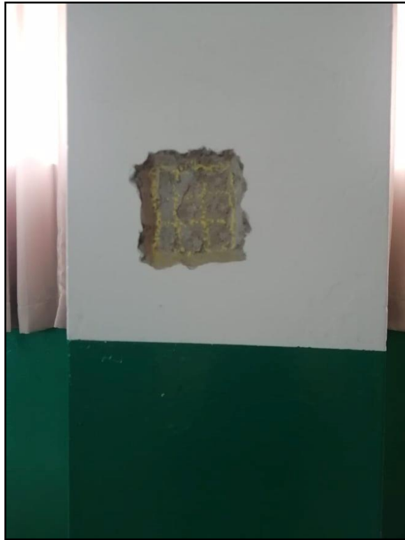
Figura 17: Corte del tarrajeo y trazos de 5cm x5cm para el ensayo de esclerometría en columnas
