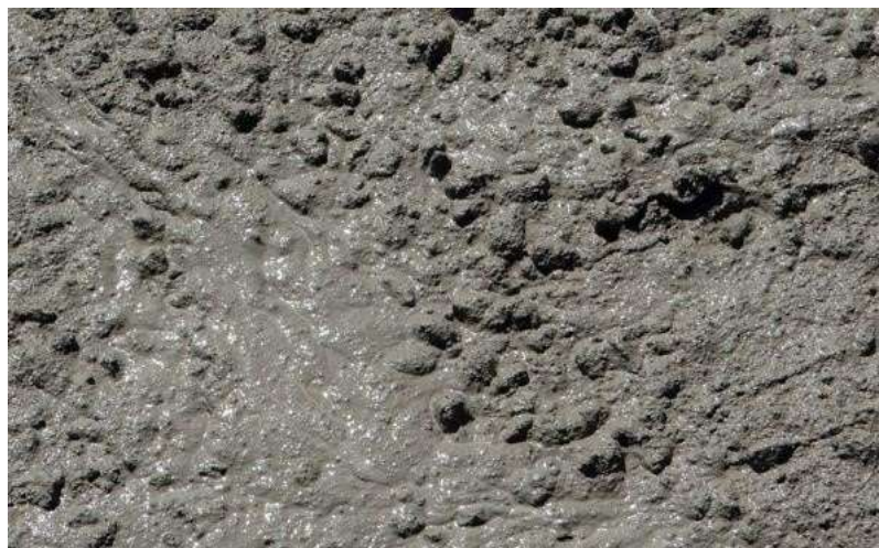
Figura 12. Segregación del concreto
