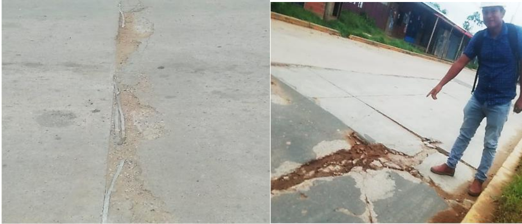
Figura 2: patologías en la Av. Aviación
