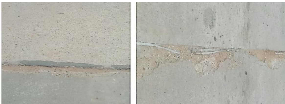
Figura 11 deficiencias en el sellado
