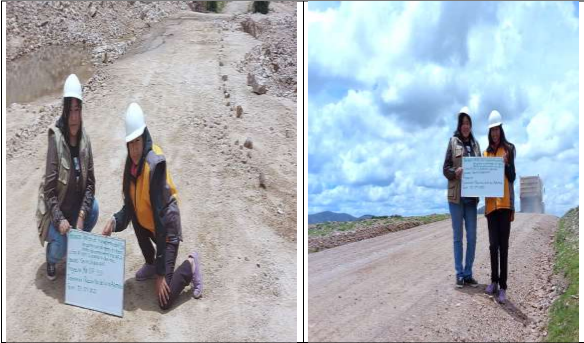
Presencia de baches en el camino
