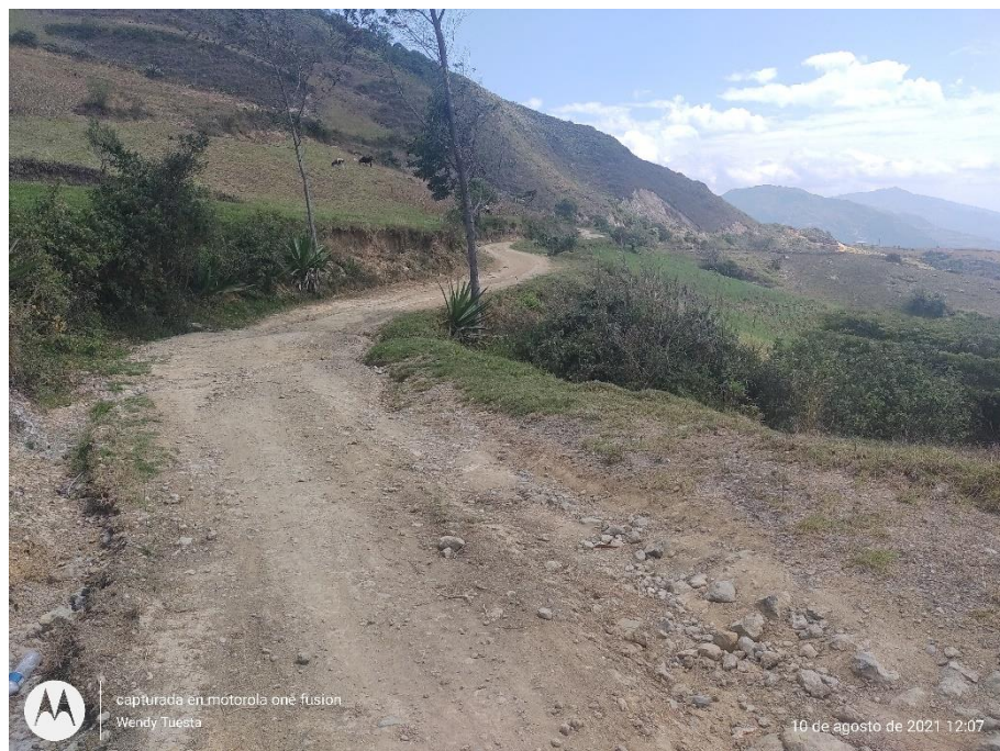
Figura 11: Estado Actual de la trocha carrozable C.P. Paltarume – Cruce Yanazara
