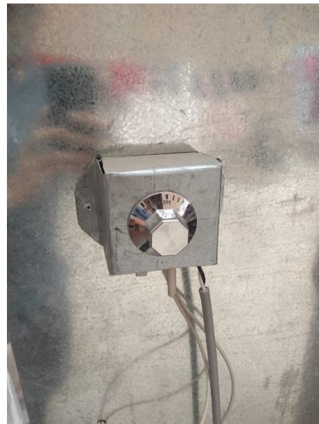
Fotografía 8. Termostato de control de temperatura.
